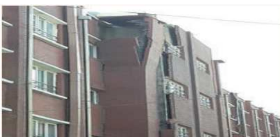
[ 외벽 파손 피해사례 ]
