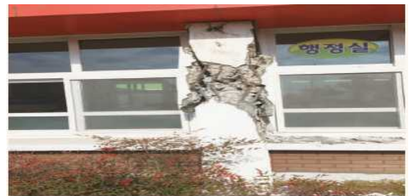
[ 기둥 파손 피해사례 ]
