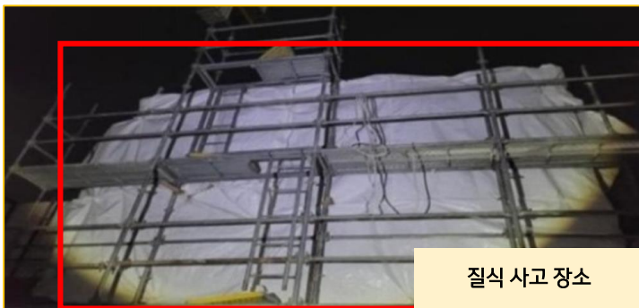
그림 3. 용인시 건설현장 사고 사례
