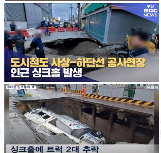
그림 8. 부산 사상구 싱크홀 사고
