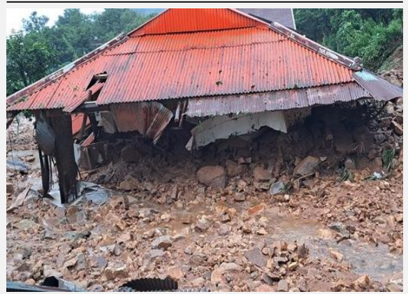
그림19. 토사 유입 및 옹벽 붕괴 예시
