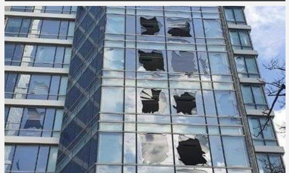
그림20. 옥외 시설물 및 건물 외벽 파손 예시
