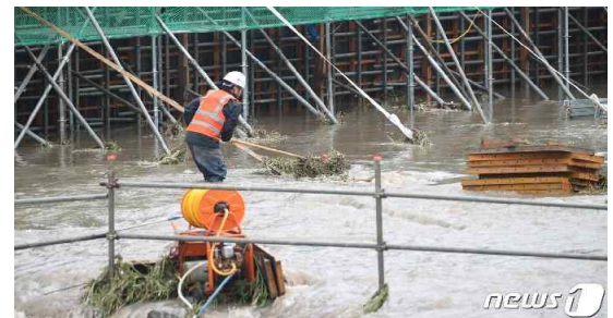
[ 부산 영도구 호텔 공사현장 침수 ]
