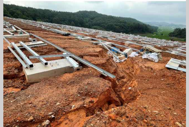
[ 강풍에 의한 구조물 파손 사례 ]
