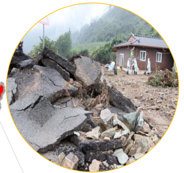
포항 도로유실 (오마이스)
